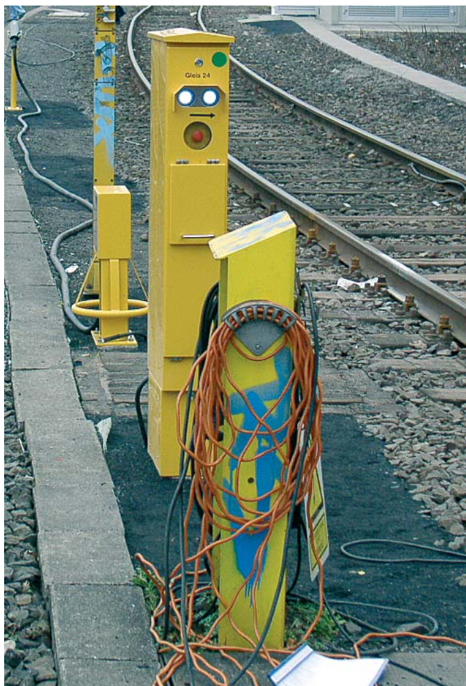
Abbildung 1: Außenanlage einer neuen EZVA.
